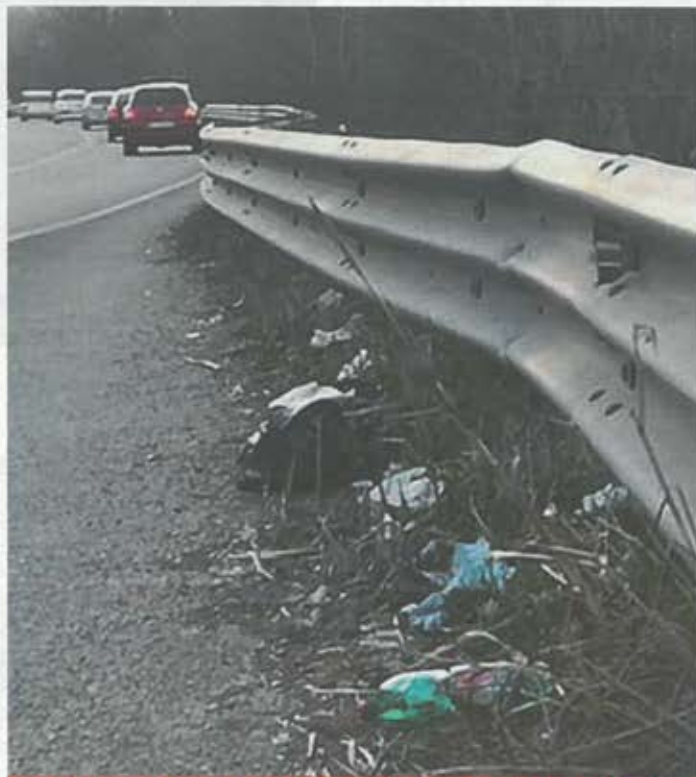
Già non mancano. Una discarica abusiva lungo la strada per Montà
